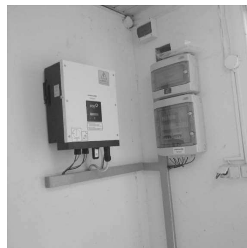
Rys. 6. Przykład a) nieprawidłowego łączenia przewodów od falownika do RG w pomieszczeniu garażu, brak uszczelnienia miejsca przejścia przewodów pomiędzy pomieszczeniami, b) rozwiązanie prawidłowe
