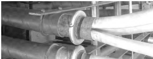
Rys. 6. Badany obiekt – kabel NAYYBY 3x240 mm 2 3,6/6 kV
